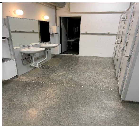
Der er sanitet og VVS installationer i nogle områder som er af nyere dato, og med forventet levetid på over 10 år som kan genbruges, hvis det bidrager til projektet.
