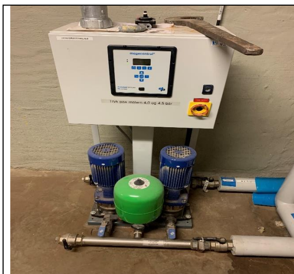
Trykforøger anlæg af nyere dato med forventet levetid på over 10 år som kan genbruges, hvis det bidrager til projektet.
